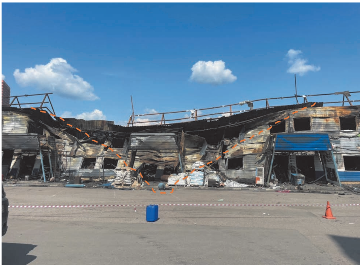
Рис. 4. Вид наиболее поврежденной пожаром части строения, границы которой обведены пунктирной линией
